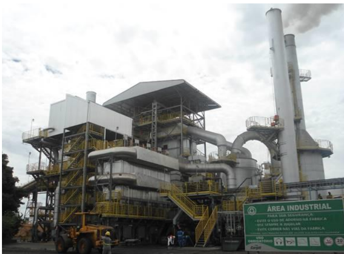
Caldeiras de biomassa
